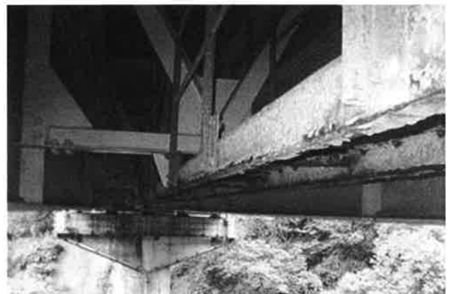
写真2 橋梁付属物の腐食例
