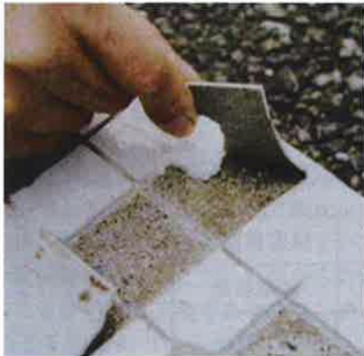
写真 3.3 塗膜のはがれ状況の一例
