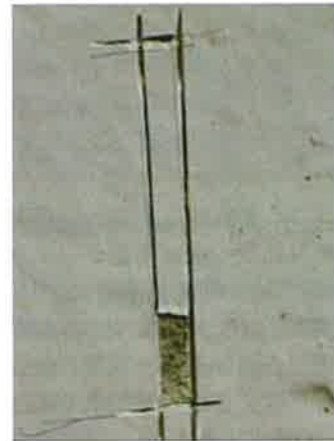
写真3.1 カッターナイフ剥離試験後の剥離状況
